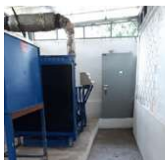
Planta eléctrica de 385 KW instalada en el Paraninfo Universitario
