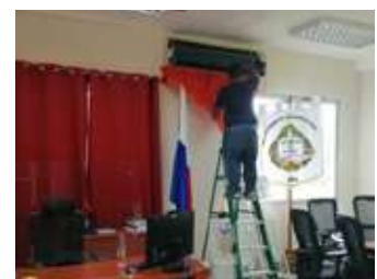
Mantenimiento de aires acondicionados
