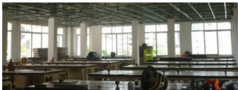
Remodelación del Edificio en el Hospital Santo Tomás para la Facultad de Medicina
