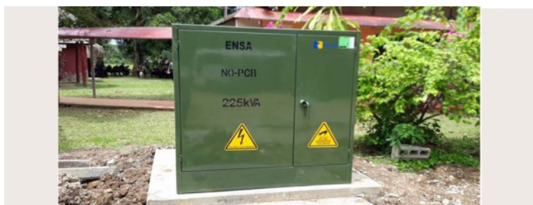
Conexión de un transformador y de todos los sistemas en el CRU de Darién
