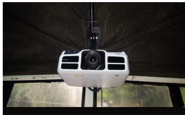
Equipo multimedia de última generación instalado en el Domo
