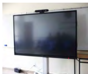
Instalación de tableros inteligentes
