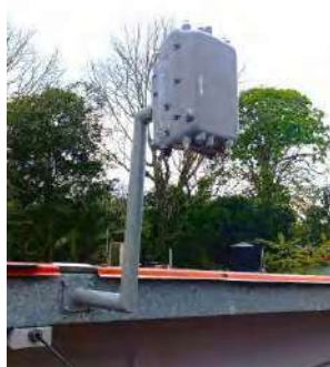
Antena en exteriores de la red SmartUP
