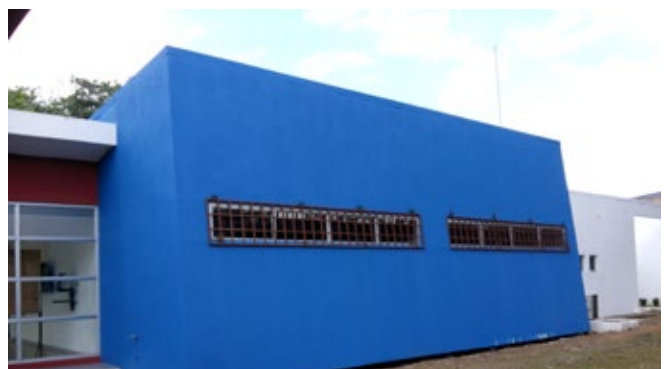
Verjas de seguridad para edificio del CIDETE
