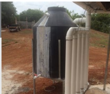
Sistema de captación de agua de lluvia de techo con autofiltrado
